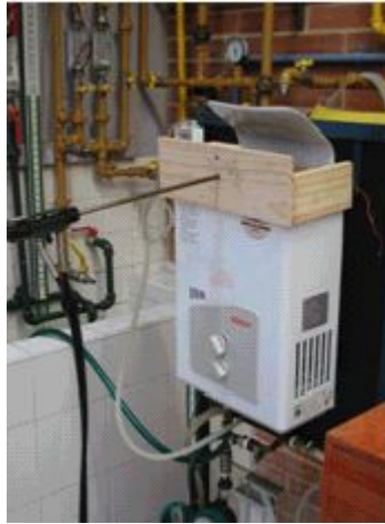
Figura 2.12. Ubicación del soporte de madera con el respectivo deflector en el calentador tipo A.
