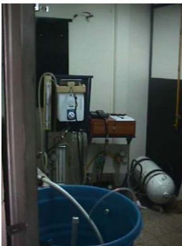
Figura 4.3 Instalaciones de las pruebas para calentadores en Manizales
