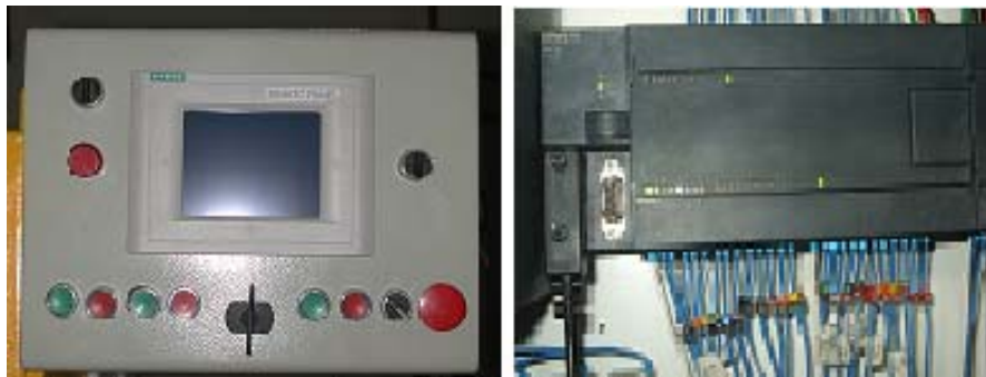
Figura 8. PLC Siemens Simatic S7-200 CPU 226, y panel táctil TP070.
