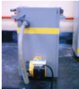
Figura 7. Bomba de recirculación
