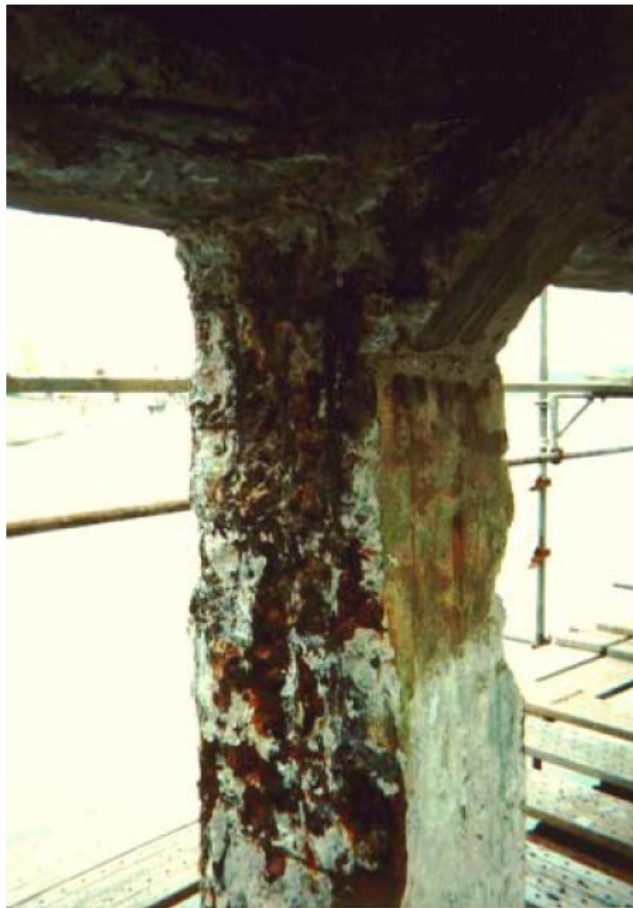
Figura 1-1. Efecto de la corrosión en las estructuras de concreto reforzado (Imagen tomada de Takewaka, K. 1991)
