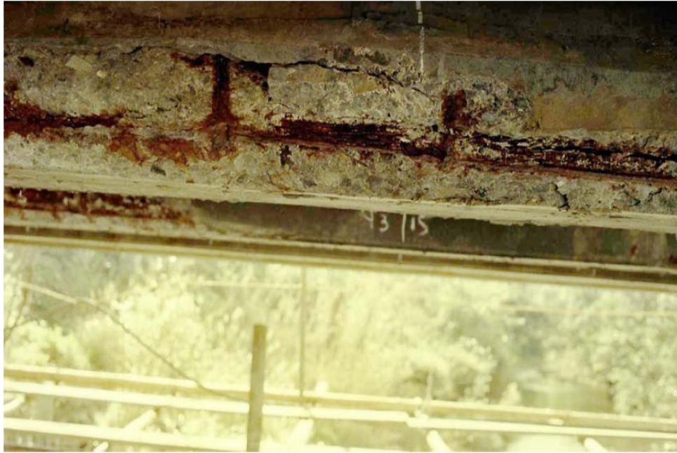
Figura 1-2. Agrietamiento del concreto reforzado (Imagen tomada de Takewaka, K. 1991)
