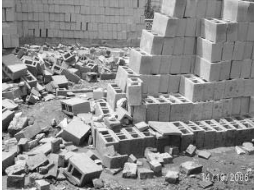
Fotografía 10. Residuos dejados al lado de material en buen estado, el material de la hilada inferior se encuentra en contacto directo con el barro.
