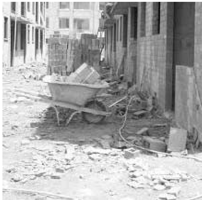
Fotografía 7. El desaseo en el lugar de trabajo incita el desperdicio de material por cuanto es más difícil detectar nuevos desperdicios.
