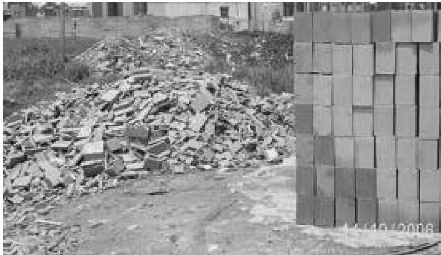
Fotografía 1. En la fotografía se observan los residuos de ladrillo provenientes de la actividad de corte.
