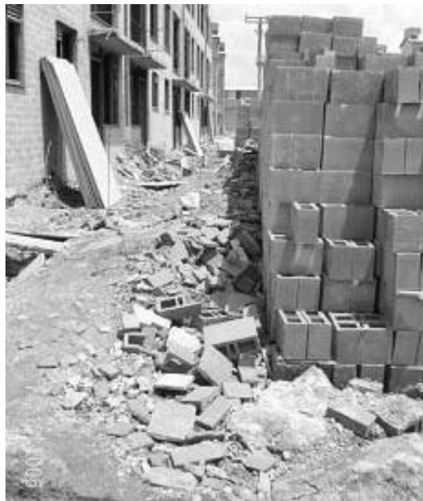
Fotografía 11. Las hiladas inferiores se encuentran enterradas bajo residuos de trabajo.
