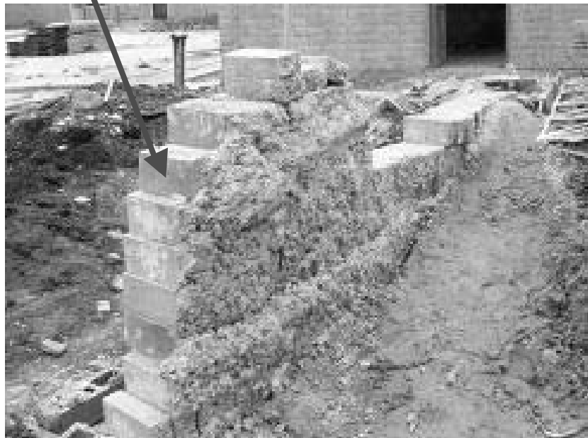
Fotografía 15 Éste material está contaminado por el mortero del mezcladero
