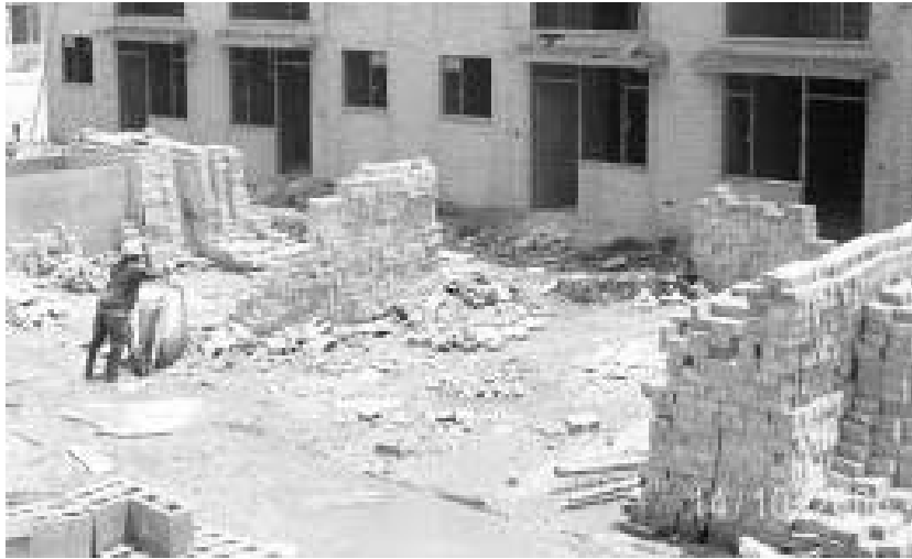
Fotografía 12. El trabajador en la imagen se encuentra botando residuos de material junto al material en buen estado.
