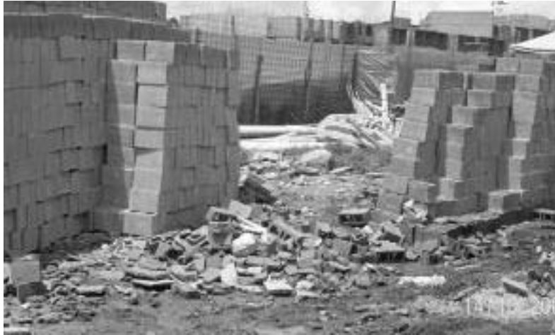
Fotografía 8. Las hiladas inferiores del material están en contacto directo con el suelo y se encuentran húmedas por el agua dejada por las lluvias.
