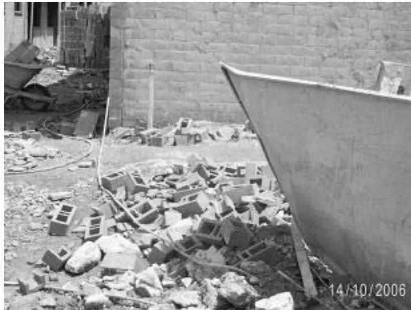
Fotografía 6. Los residuos de material no son depositados en un lugar específico, esto genera desorden y hace que algunas unidades completas se pierdan al mezclarse con el material dañado.
