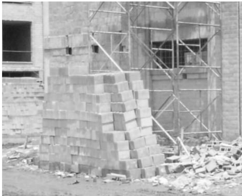
Fotografía 5. Material sumergido en el barro y con peligro de caerse por falta de adecuación del lugar de almacenamiento.
