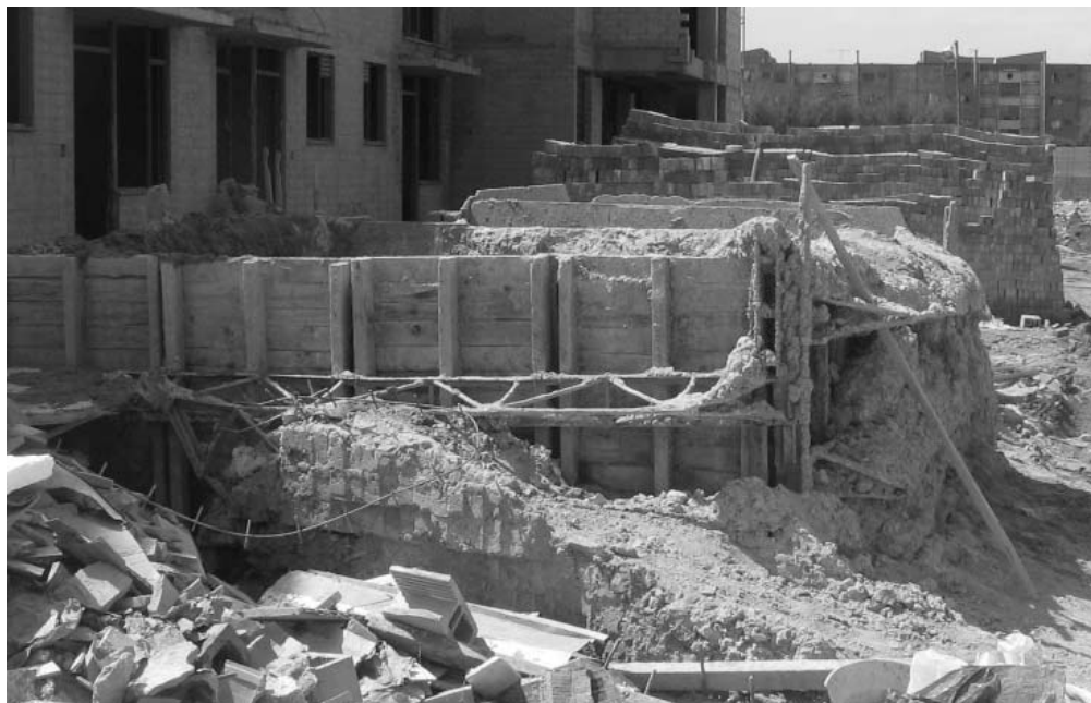
Fotografía 16. Imagen de Mezcladero (recibidero).
