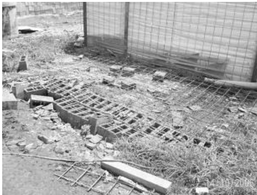
Fotografía 3. Hilada inferior del material que sufrió daños debido a la humedad.
