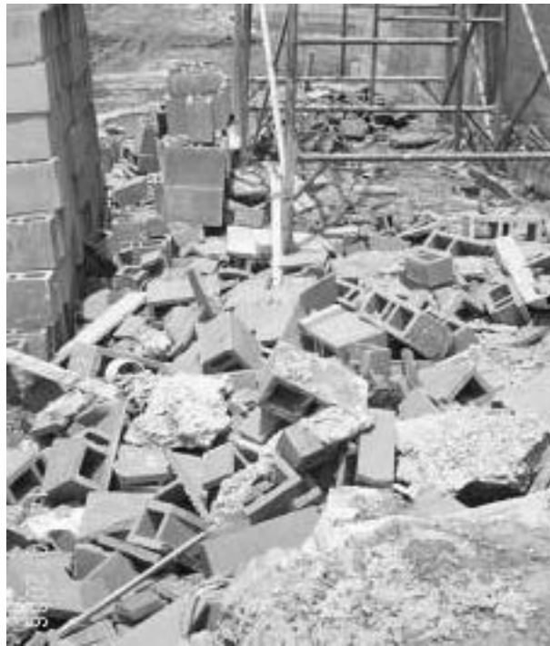
Fotografía 9. Los residuos del material no son depositados en un lugar adecuado para éste propósito. Esto limita el espacio de trabajo y propicia las pérdidas del material entre los escombros.
