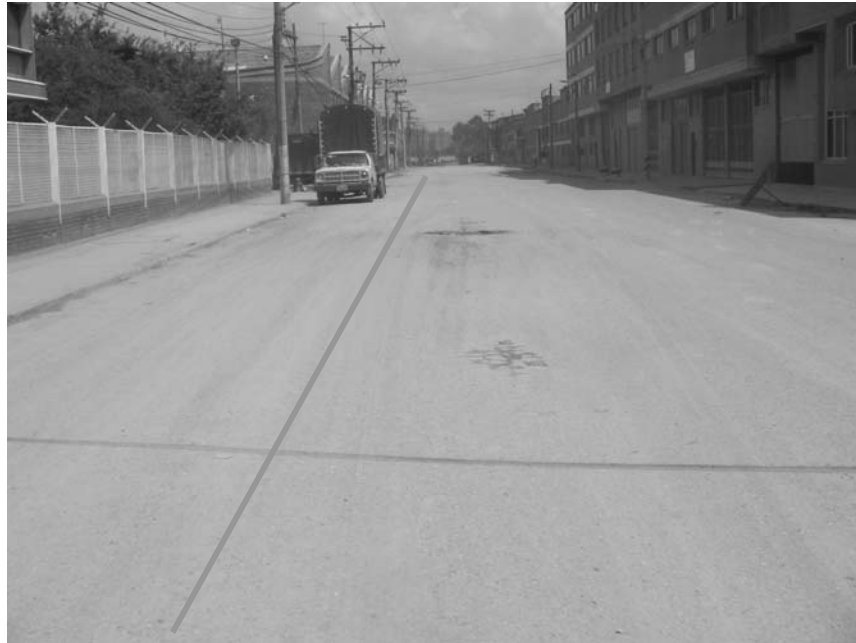
Tramo 1 : Pavimento flexible en estado regular.
