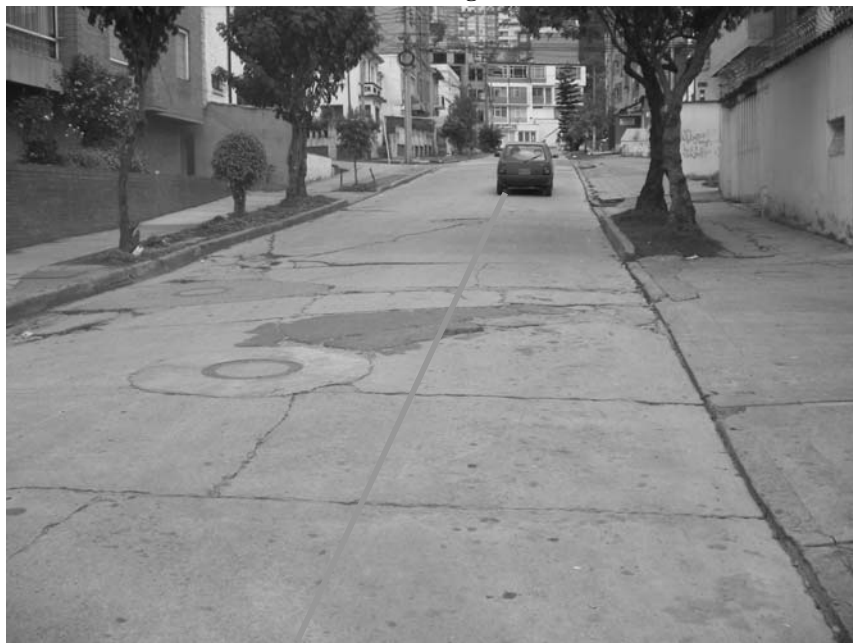
Tramo 4 : Pavimento rígido en mal estado.
