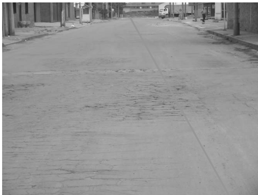
Tramo 2 : Pavimento flexible en mal estado.
