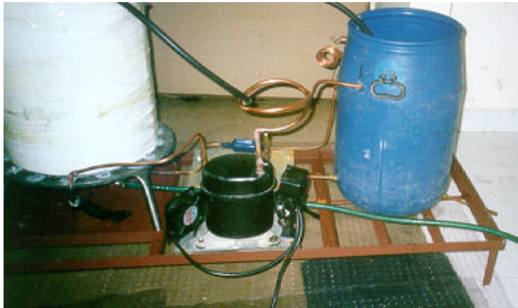
Foto 4-1 Equipos sobre la estructura metálica.
